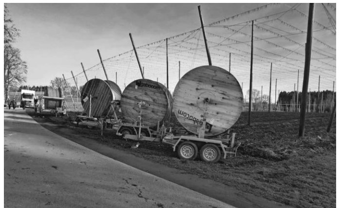
Die Kabeltrommeln mit den unterschiedlichen farbigen (in s/w leider nicht sichtbar) Kabeln.
