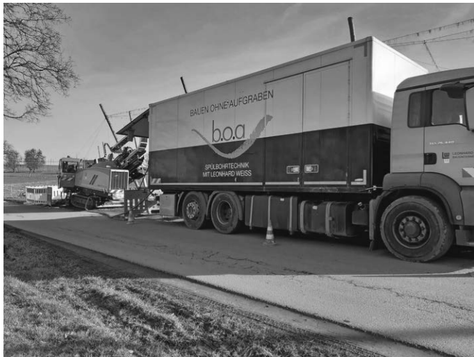
Hier im LKW wird das Spülwasser gereinigt und dann der Kläranlage zugeführt.
